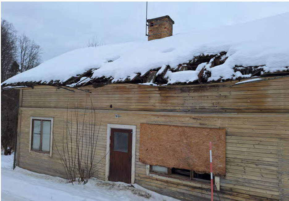
Bild 2. Byggnadens södra fasad. Taket har börjat rasa in på två ställen och det finns inget som stoppar vatten att tränga in i konstruktionen.
