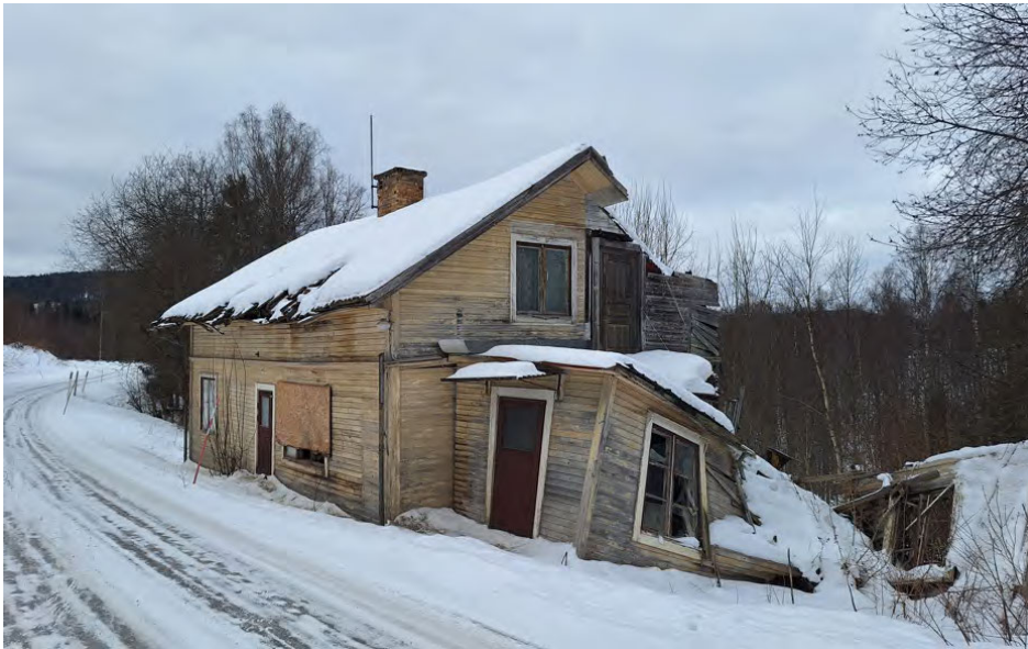
Bild 1. Byggnadens södra samt östra fasad. Delar av en utbyggnad håller på att rasa ihop.
