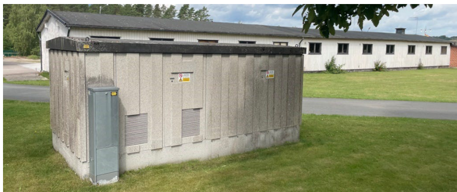
Transformatorstation i området södra del intill Magistervägen.
