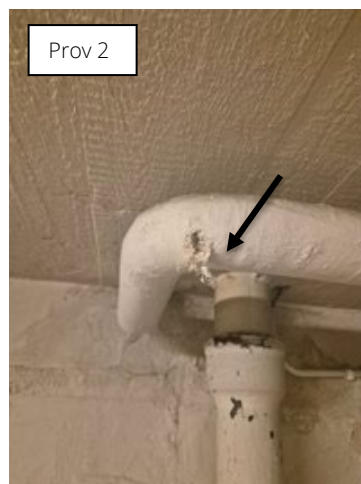
Figur 9. Rörböj. Innehåller asbest.
