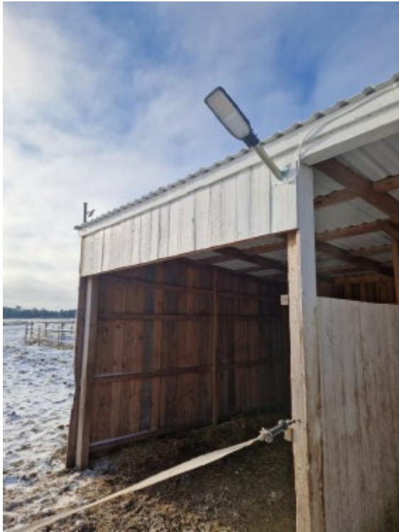
Bild 1. Lampan på vindsyddet
